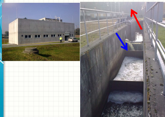
ČOV dosazovací nádrže, odtok postdenitrifikace
